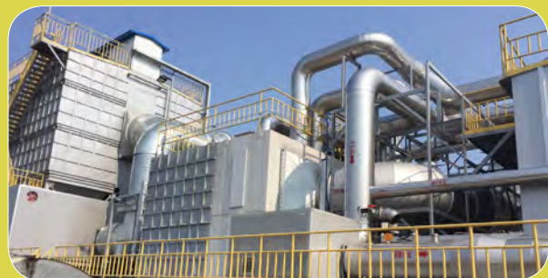
正在实施的炼胶烟气治理项目
